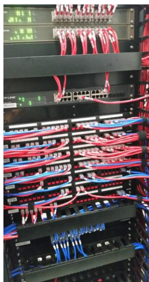
Figura 3: Foto de exemplo 1 montagem rack.
