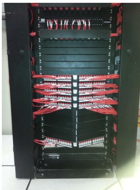
Figura 4: Foto de exemplo 3 montagem rack.
